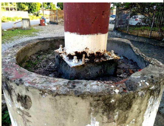
Estrutura comprometida no posto fiscal de Cruz de Almas
